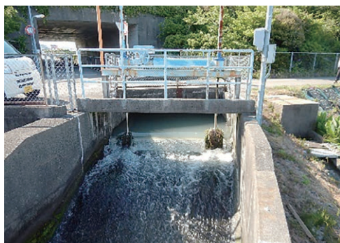
施工前 スライドゲート
