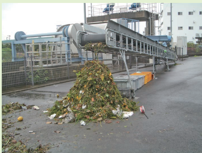
島田市細島 志太榛幹線第三分水工除塵機
